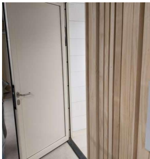
Binnenzijde toiletdeur zonder horizontale beugel
