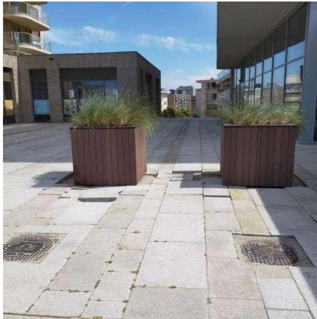
Bestrating waarbij tegels ontbreken en met een aantal gebroken tegels
