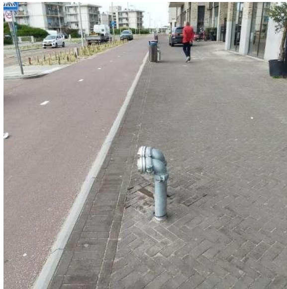
Aansluiting voor brandslangen op het trottoir
