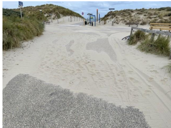
Opgestoven zand op het fietspad
