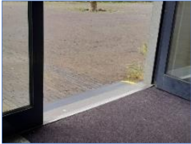
Drempel bij de voordeur sluit niet geheel aan bij de entree en heeft twee helingshoeken.
